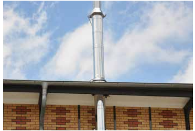
Über Dach setzt sich die Abgasleitung in gängiger Edelstahloptik fort.
