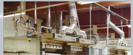
Großbäckerei – ausgestattet mit Edelstahlabgasanlagen von Raab
