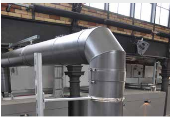
Die Abgaslösung für den Backofen wurde mit einem Edelstahlschornstein vom Typ DW aus dem Hause Raab realisiert.
