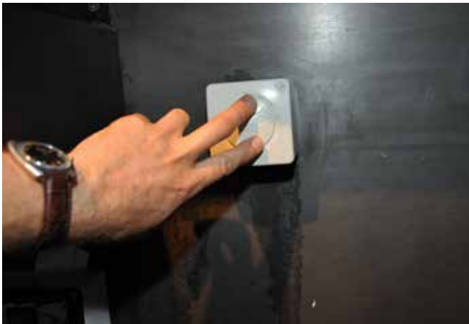
Der Schalter für den Rauchsauger befindet sich in unmittelbarer Nähe zum Ofen.
