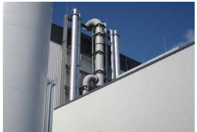
Die Mündung der Abgasanlage befindet sich in einer Höhe von ca. 25 m über dem Gelände.
