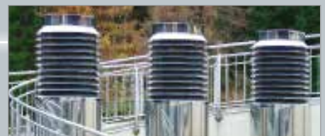
Tiefgarage – ausgestattet mit Raab Lüftungstürmen
