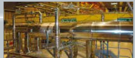
Autoclav – ausgestattet mit Edelstahlabgasanlagen von Raab und Komponenten von Kutzner + Weber
