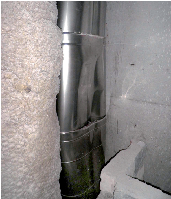
Beispiel an einer großen Abgasanlage was im ungünstigsten Fall passieren kann.
