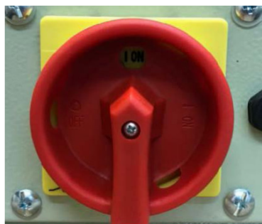
Abb. 19: Einschalten der Steuerung
