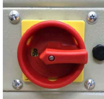
Abb. 27: Ausschalten der Steuerung
