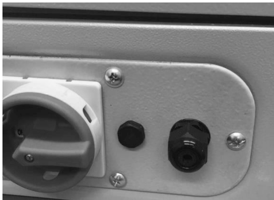
Abb. 56: Ansicht PG-Verschraubung Wetterschutzkasten
