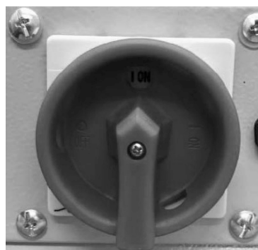
Abb. 58: Einschalten der Steuerung
