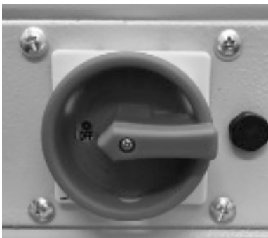
Abb. 3: Not-Halt = Hauptschalter, Outdoor, mit Wetterschutzkasten
