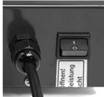
Abb. 39: Einschalten der Steuerung
