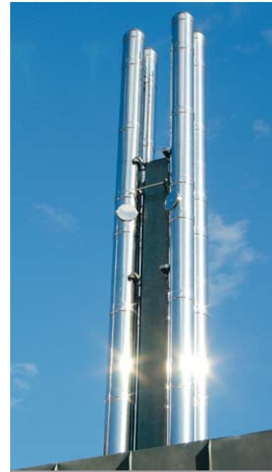
Verlängerung Rauchgaszüge einer Metzgerei 4 x \varnothing 150 mm, Tragmast 300 x 300 mm
