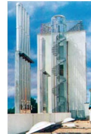
Großbäckerei Ludwigshafen: Edelstahl-Abgasanlage mit Sonder- konstruktion passend zur Gebäude- architektur
