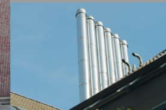
Kinokomplex Lörach: Abluft Tiefgarage + Kinosaal, 2 Abgasleitungen, je \varnothing 300 mm, innen tragend, Verkleidung Edelstahl glänzend
