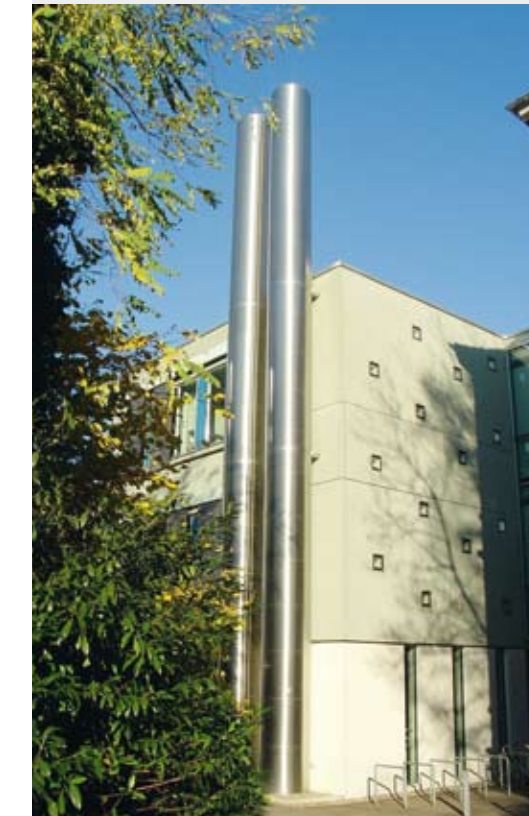
Laborgebäude Freiburg: Abluft PPS-tragend, 2 x \varnothing 900 mm, 50 mm Isolierung, Verkleidung Edelstahl glänzend
