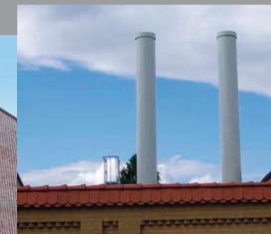
Bundeswehrcaserne Leipzig: 2 geschweißte Anlagen, außen tragend, \varnothing 2 x 500 mm, Oberfläche weiß lackiert
