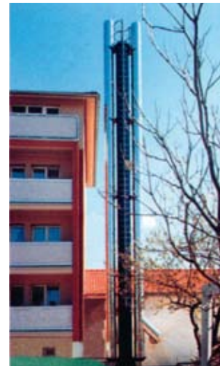
Heizhaus Trebbin: Mastanlage für ein neues Wohn- gebiet – harmonisch an die Umgebung angepasst
